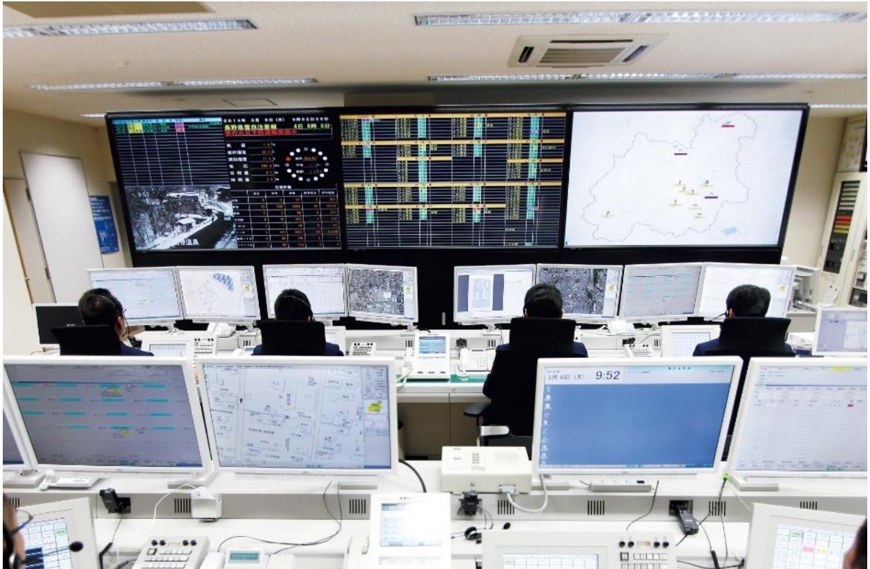
消防救急デジタル無線設備・消防通信指令システム
