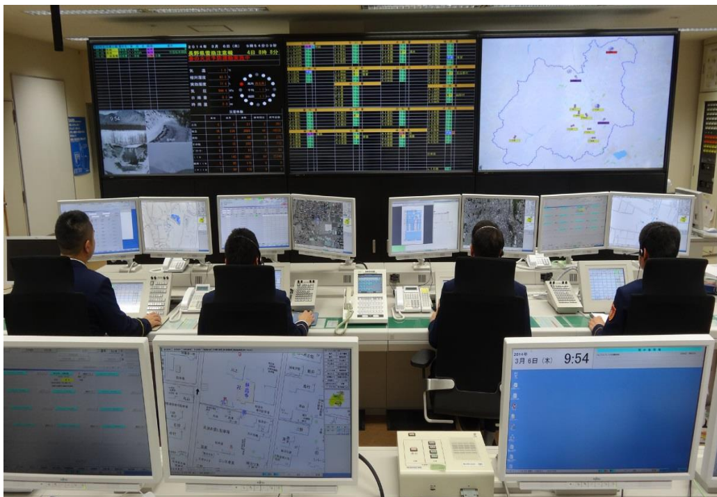
消防救急デジタル無線設備・消防通信指令システム（平成25年）
