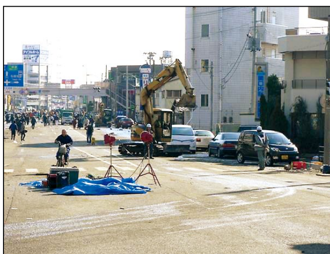
重機による車両除去 避難する市民
